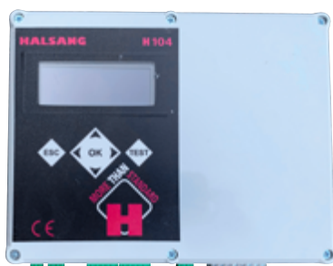
Armoire électrique équipée d'un contrôleur Halsang H104 et de modulateurs de fréquence
