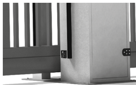
Armoire de commande avec photocellule.
