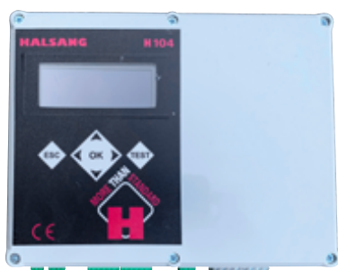
Armoire électrique équipée d'un contrôleur Halsang H104 et de modulateurs de fréquence
