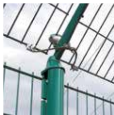
Mise à la terre
